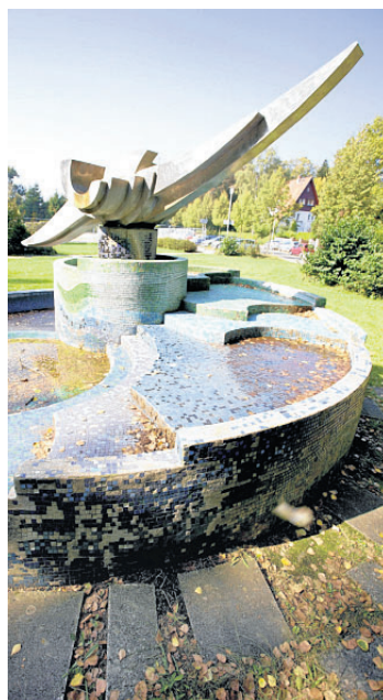
Baufällig: der Buchschlager Schneckenbrunnen. SASCHA RHEKER
